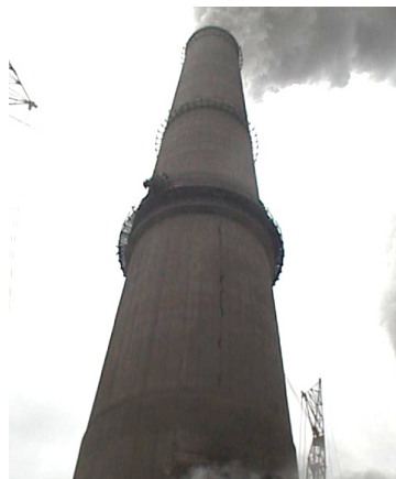
Coșul de fum nr.2 (defect în structură) CET - Rovinari
